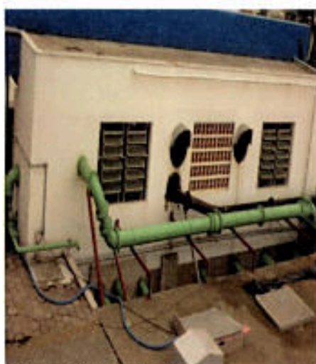
Figura 8. Casa das bombas.
