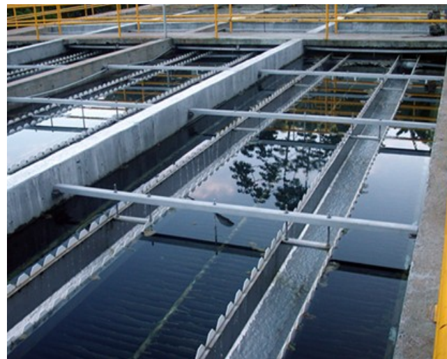
Imagem 2 – Tanque de floculação
